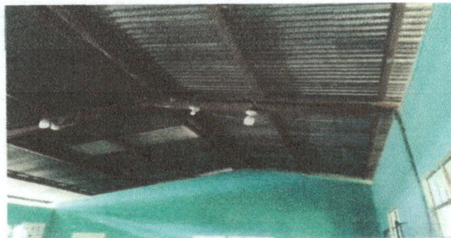
Foto 2: Las costaneras están oxidado y están en mal estado, se necesita cambiar.
