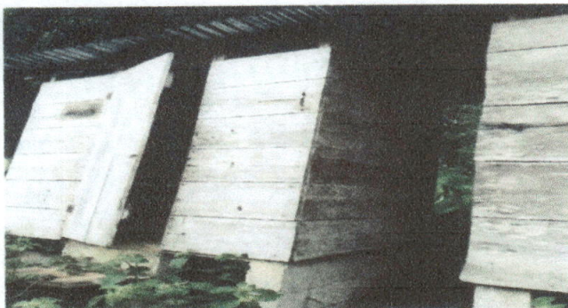
Foto 3: En la vista de los baños no están en funcionamiento debido a que están en mal estado, es por eso se necesita construir dos nuevos baños.
